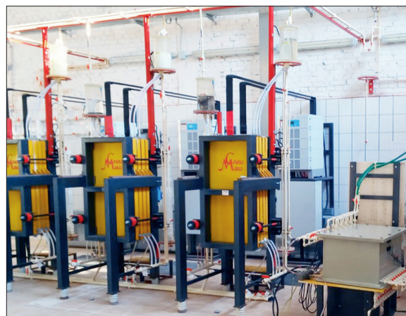
Общий вид установки-прототипа КЭА на водоканале
